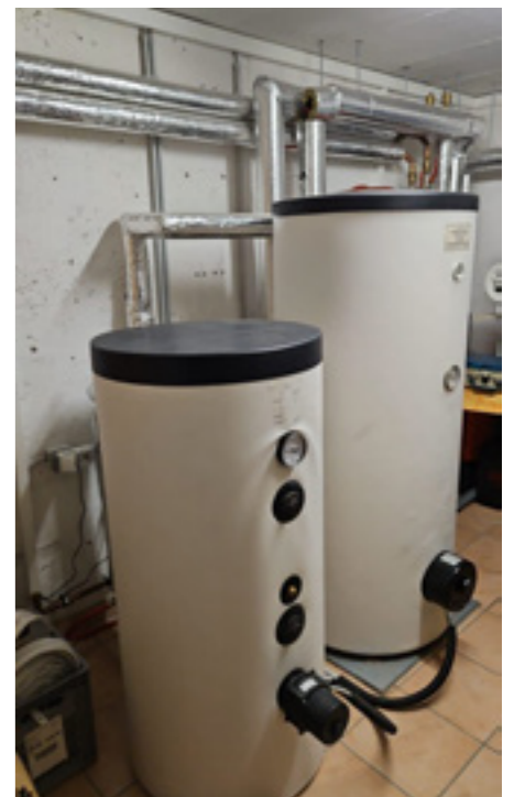
Warmwasser- und Pufferspeicher
